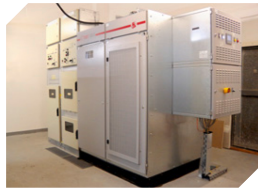
Der für VEM speziell neu entwickelte Softstarter für ein maschinen- und netzschonendes Anfahren und Synchronisieren von 10-MVA-Sy-Sy-Bahnumformern. Foto: F&S PROZESS-AUTOMATION GmbH
